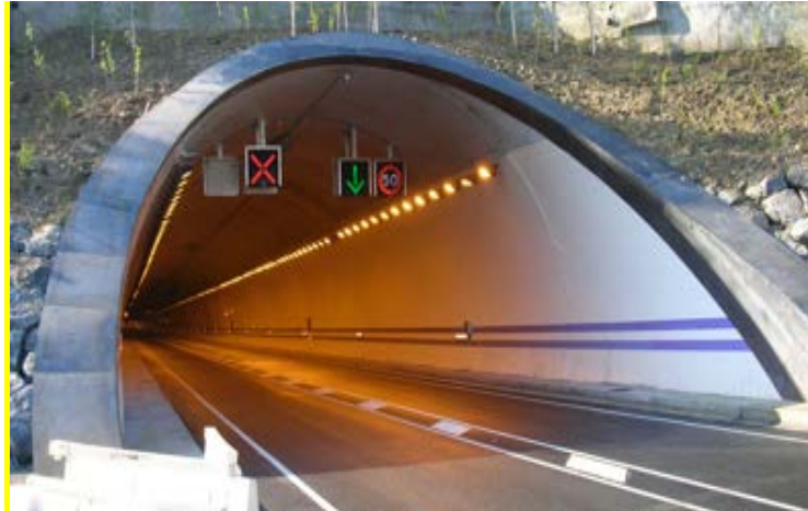
FIGURA 12.- Iluminación de túnel
