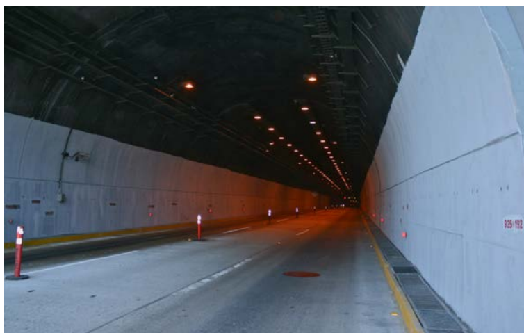
FIGURA 11.- Vista de falta de acotamientos.
