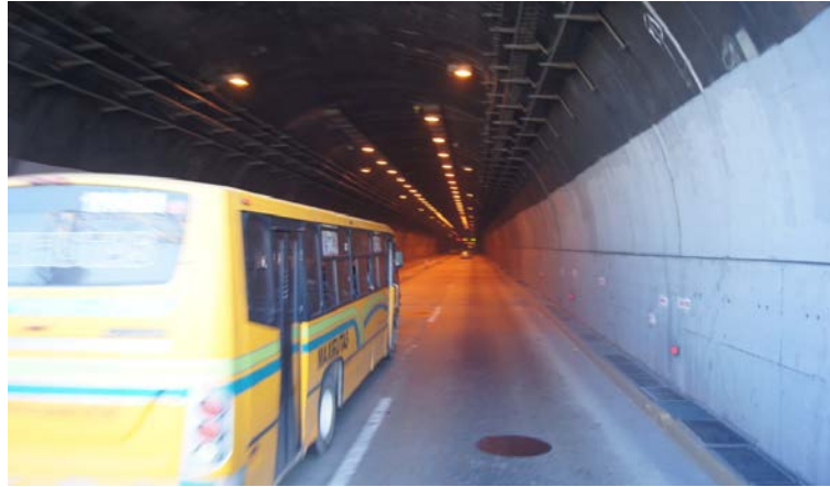
FIGURA 9.- Vista del inicio del túnel de día e iluminación artificial.
