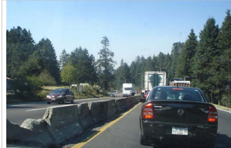
FIGURA 11. Deterioro de la barrera central
