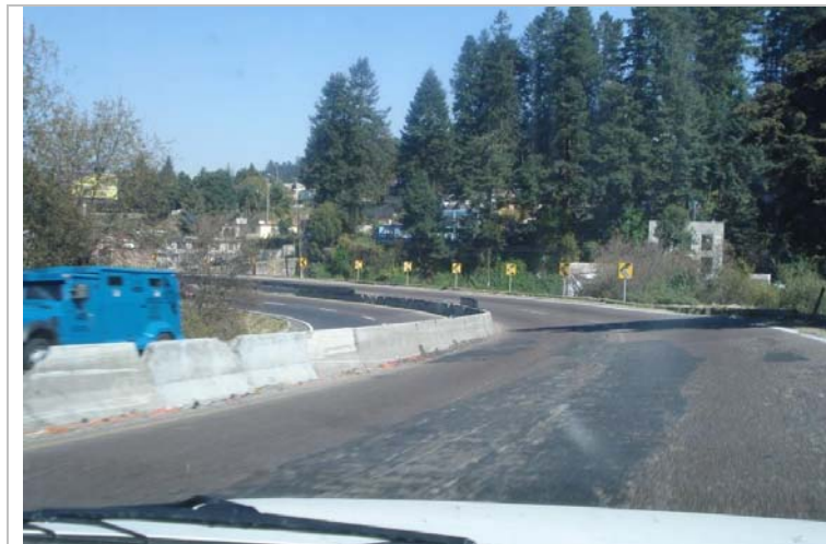
FIGURA 12. Mal estado del pavimento, los elementos de contención y de las señales verticales y horizontales
